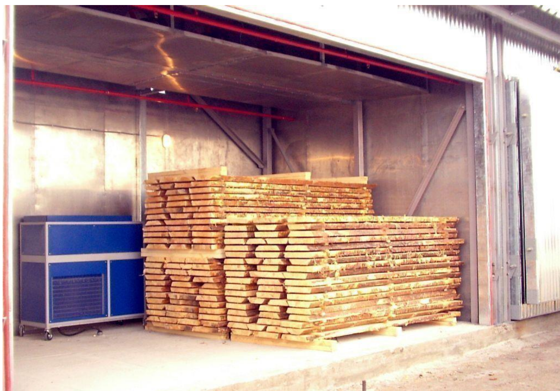
Агрегат АКС-30 установлен внутри камеры
