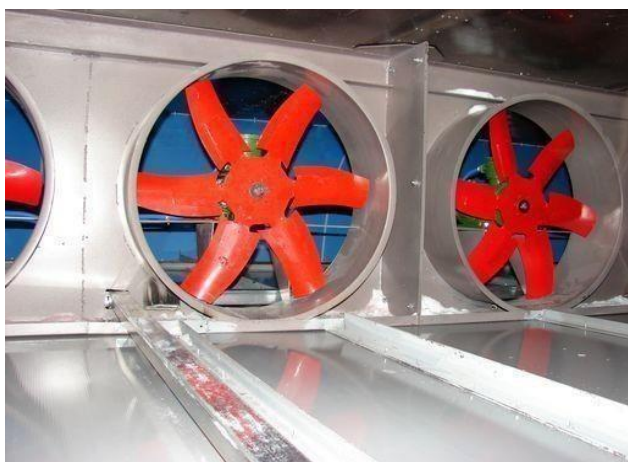
Вент. Узел в камере над фальшпотолком
