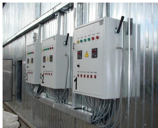
Щит управления сушильными камерами
