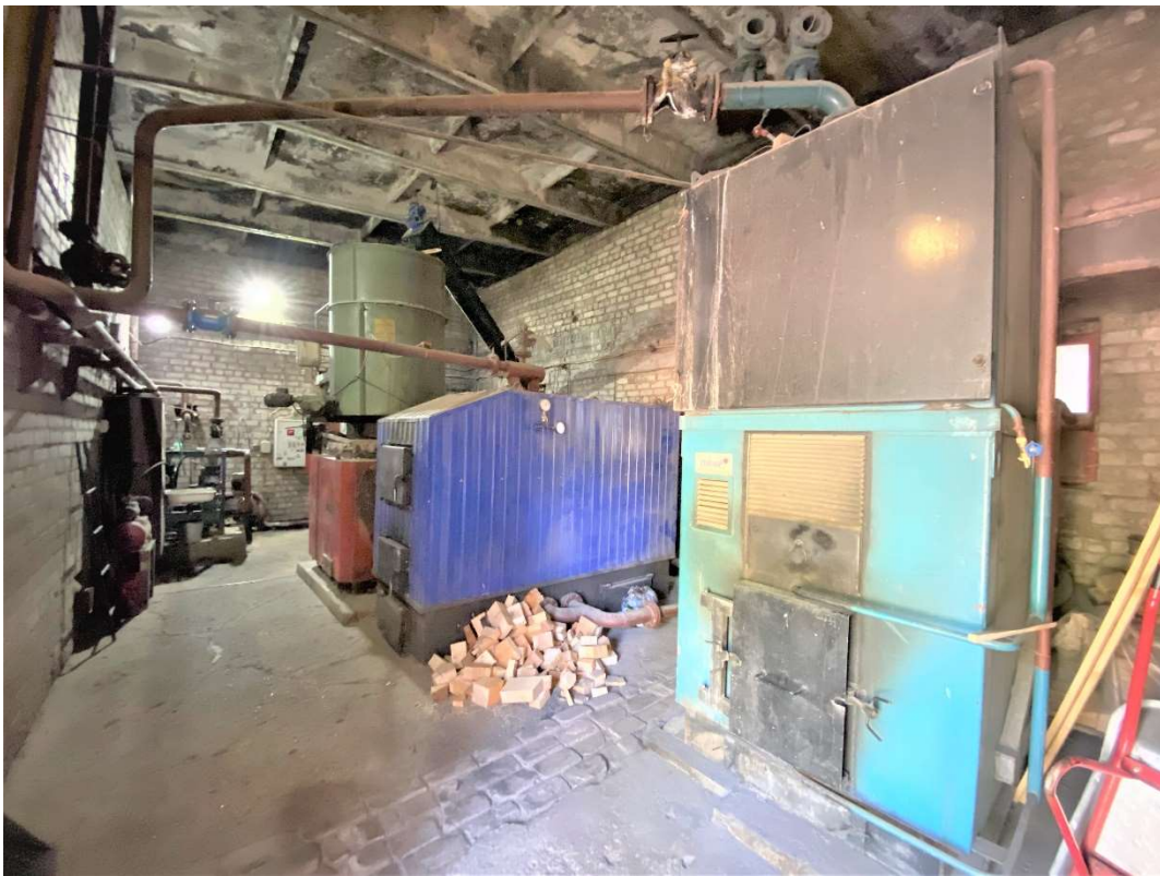
Котельная, общий вид
