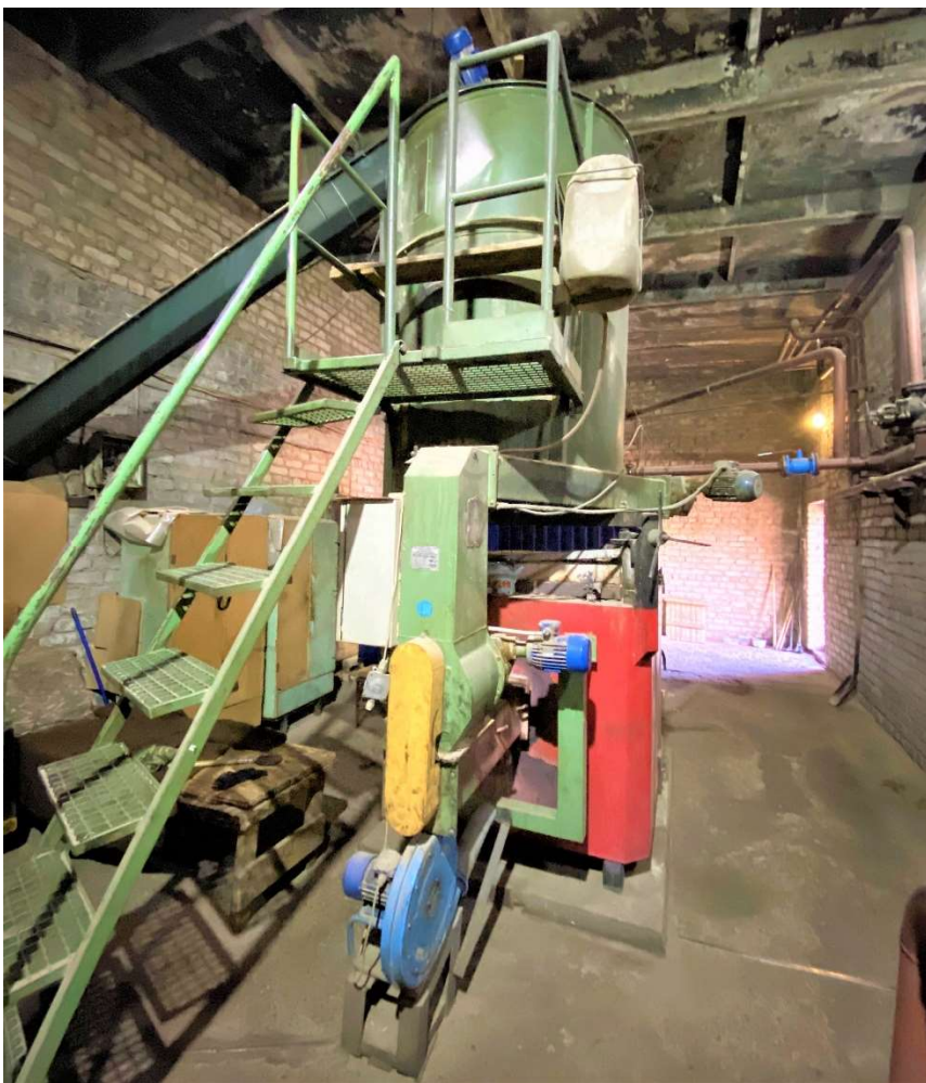
Котельная, Бункер подачи и Газогенератор
